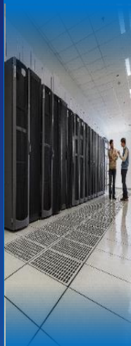
DATA CENTER DCG
